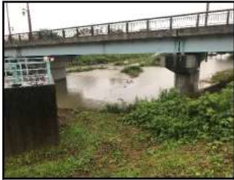
喜多川樋門で排水しきれない
