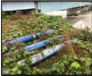
堤防をまたぐため、パイプが楕円形になり更に能力ダウン
